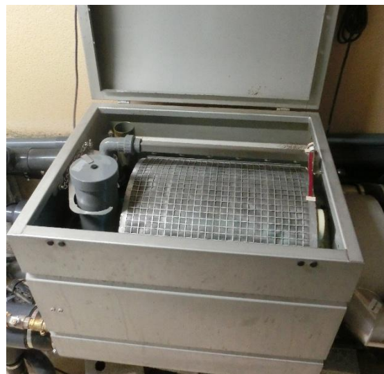
2 pompes de 20 m 3 /h alimentent le filtre.
